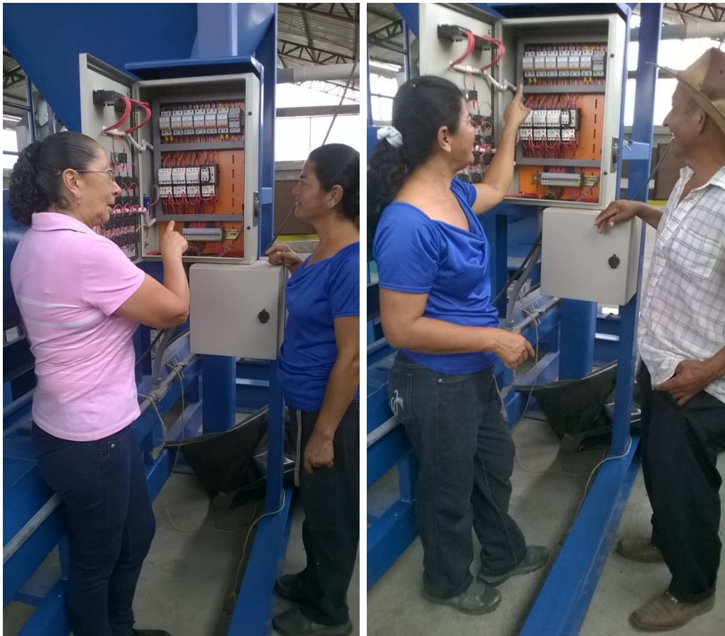
Capacitación a los beneficiarios en el tablero de control para operación del equipo.
