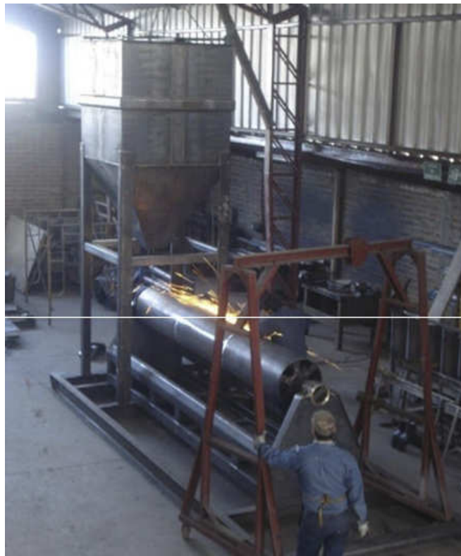
Ensamblaje de la planta
