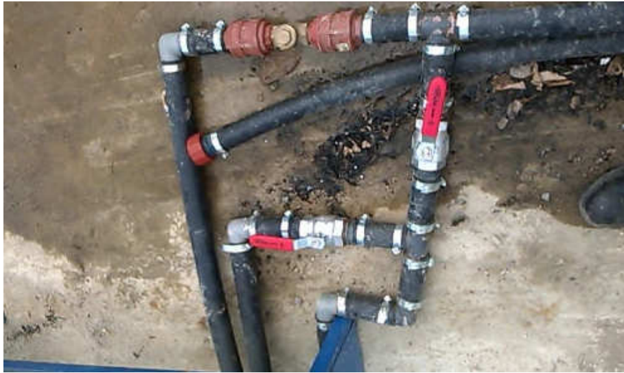
Sistema de llaves de paso del agua caliente hacia el radiador.
